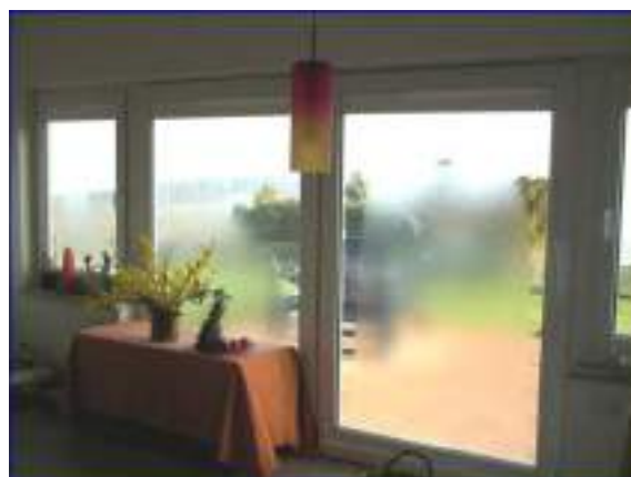
Figure 20 : Condensation sur la face d'un vitrage côté extérieur d'un local.
